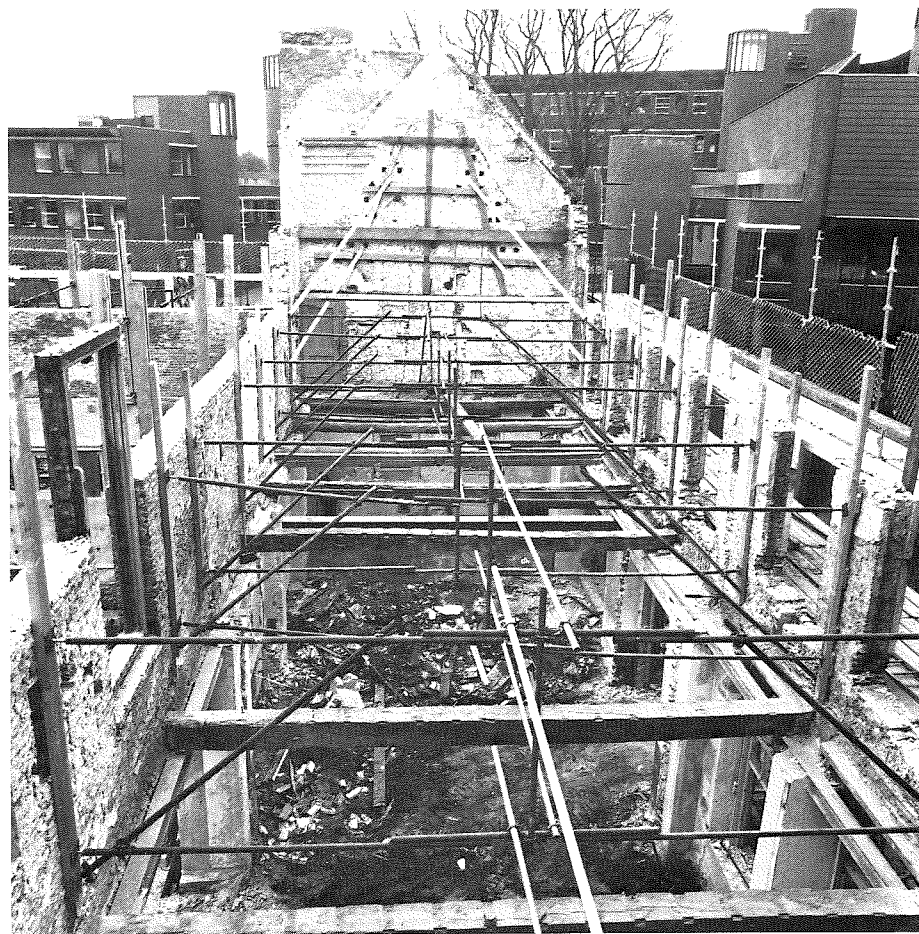
Slechts de gevels bleven staan (vleugel D).
