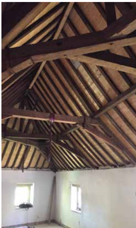
Boven: Bij de verbouwing zijn verlaagde plafonds verwijderd en is de kap weer zichtbaar.
