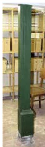
▶ Eén van de zes op een bakstenen poertje geplaatste houten kolommen die de troggewelfjes ondersteunen.
