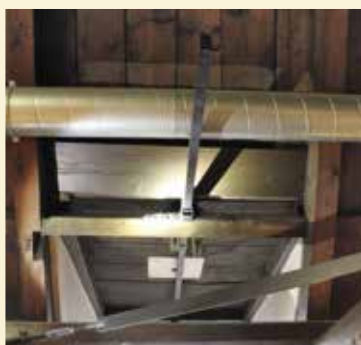
▲ Uitschuifbare hijsbalk in de linker kapel aan de achterzijde.
