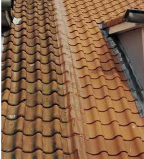
▲ Detail van de aansluiting van oude op nieuwe dakpannen aan de Celzusterenstraat waarmee Monumentenzorg niet akkoord ging. Bureau Monumentenzorg
